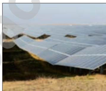
Рис. 33. Солнечная электростанция «Бурное Solar-1» в Жамбылской области
